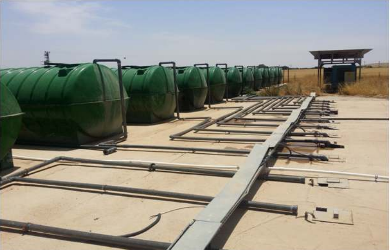
Viranşehir çadır kentin paket arıtma tesisine ait, kesin kabul için gidildi.
