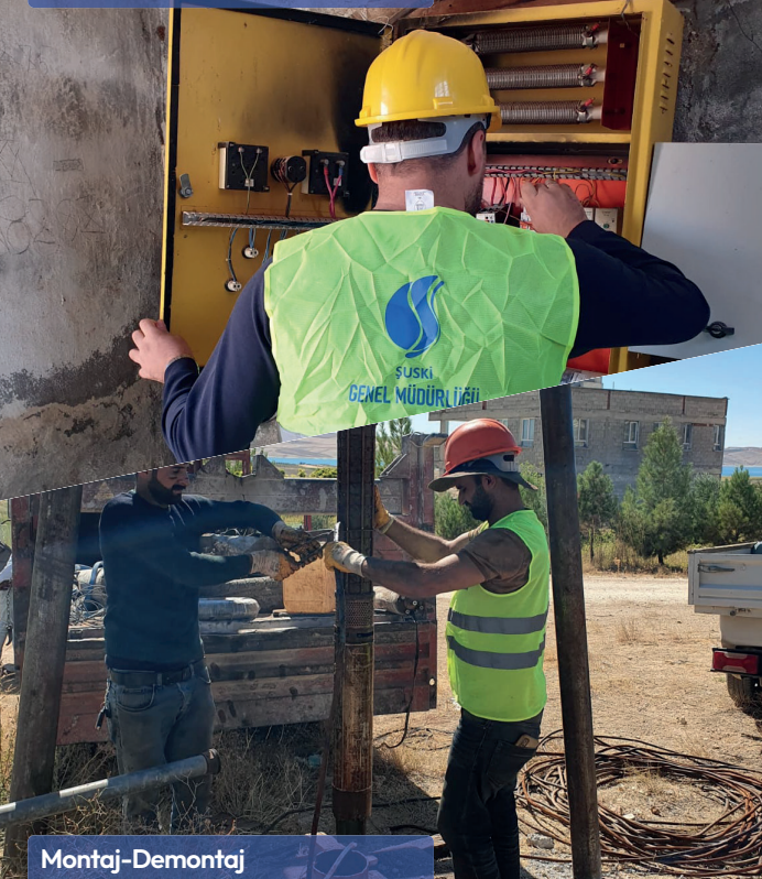
Pano Arızası Onarımı
